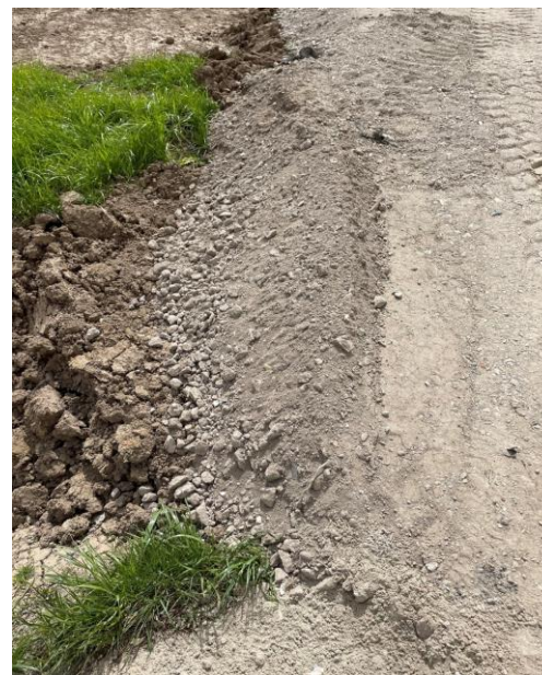
Immobilisaat: niet goed verdicht/verkit
